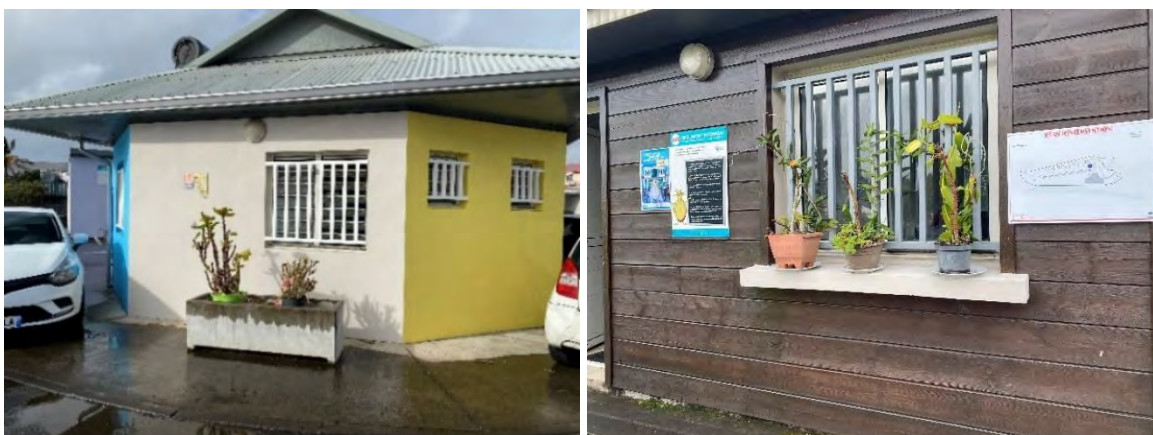
Figure 1 : Rénovation de peintures à Grand Canal et traitement du revêtement bois à Centre-Ville
